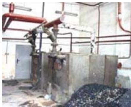
Kotłownia opalana węglem
