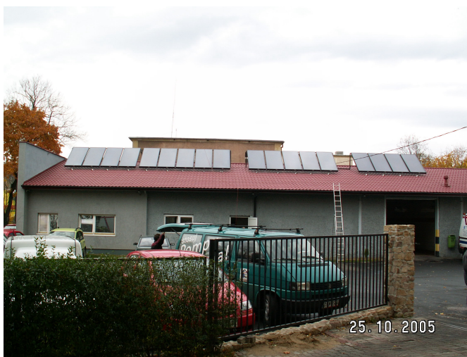
Widok budynku z kolektorami słonecznymi na dachu
