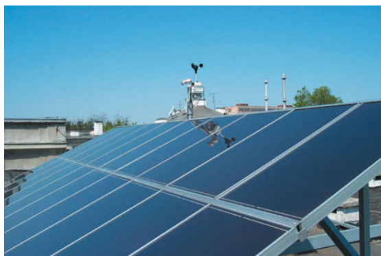
System fotowoltaiczny na Szkole Podstawowej nr 76 w Warszawie Falenicy
