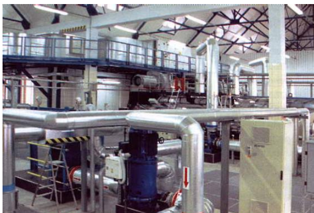
Ciepłownia Szczytowa Geotermalno – Gazowa w Zakopanem – widok ogólny
