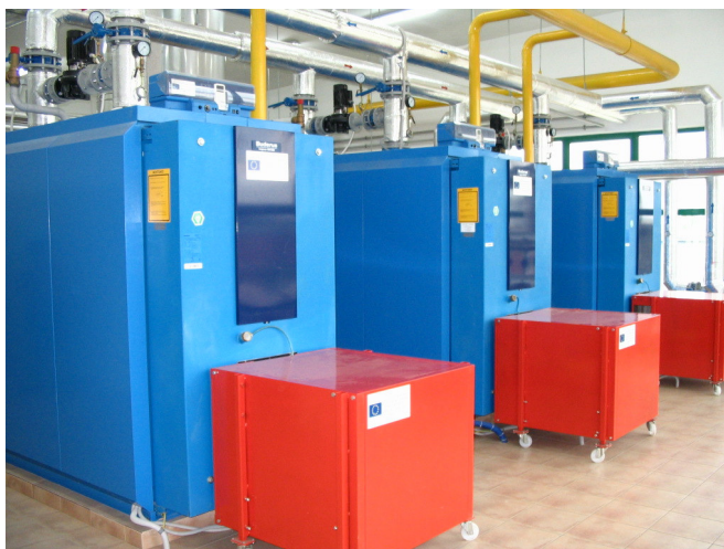
Wnętrze zmodernizowanej kotłowni
